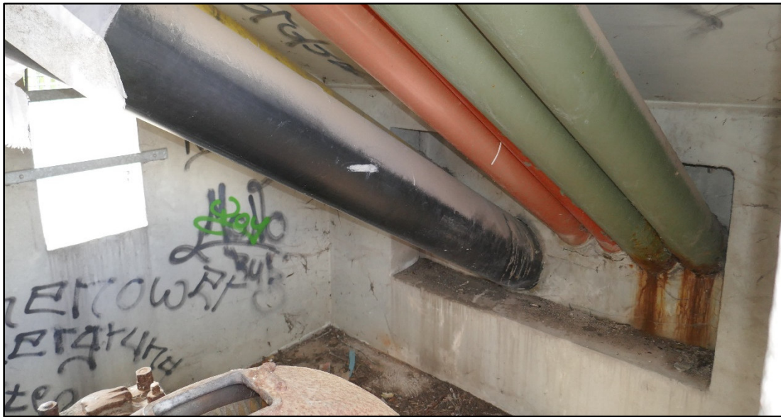
Bild 3.2-17 Fußgängerbrücke. Nördliche Treppe. Blick im Maschinenraum auf die östlichen Schutz- und Leerrohre der E.ON / e.dis AG für Elektrokabel (2 x grün, belegt) und (2 x braun, leer).
