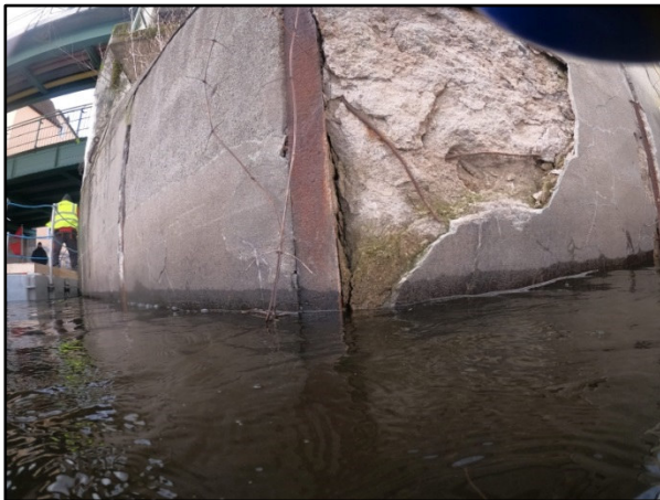
Bild 4.2.3-1 Uferstützwand NO, Betonabplatzungen an der östlichen Seite; aus Anlage 1 , Bild „Abplatzung an der ...“
