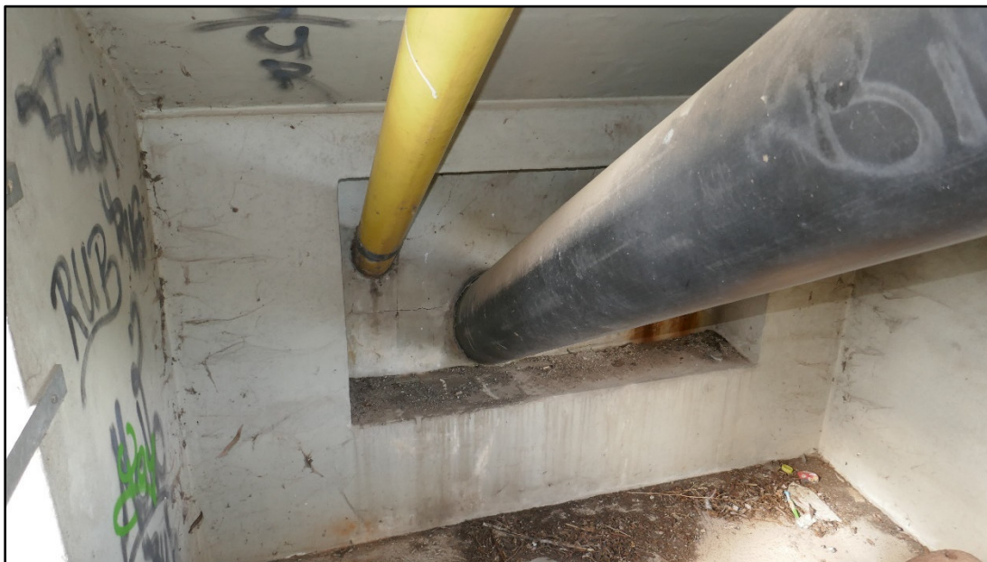
Bild 3.2-18 Fußgängerbrücke. Nördliche Treppe. Blick im Maschinenraum auf das westliche Schutzrohr der TW-Leitung des WAV Rathenow und die Gasleitung (gelb) der NBB Netzgesellschaft.
