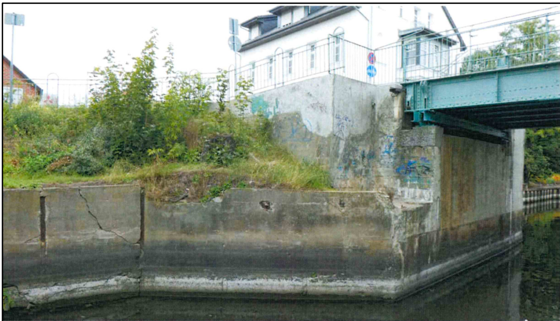
Bild 3.2-23 Ähnlich Bild 3.2-3 . Blick mehr auf den Flügel NW und die anschließende Uferstützwand NW. Links die Fortsetzung der Uferstützwand NW nach Westen hin; Bild 7 aus [1].
